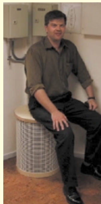
Leif Westlund sitter på en elmiljötransformator placerad i ett kapprum i ett kontor.
